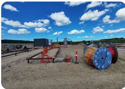
Parc de batteries (BESS)
